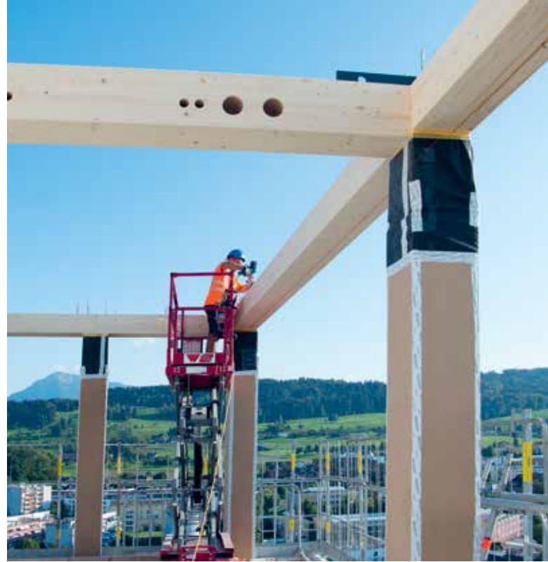
Die Vorfertigung der Holzelemente verkürzt die Bauzeit und bringt wirtschaftliche Vorteile. (Bild: Hans Galliker)
