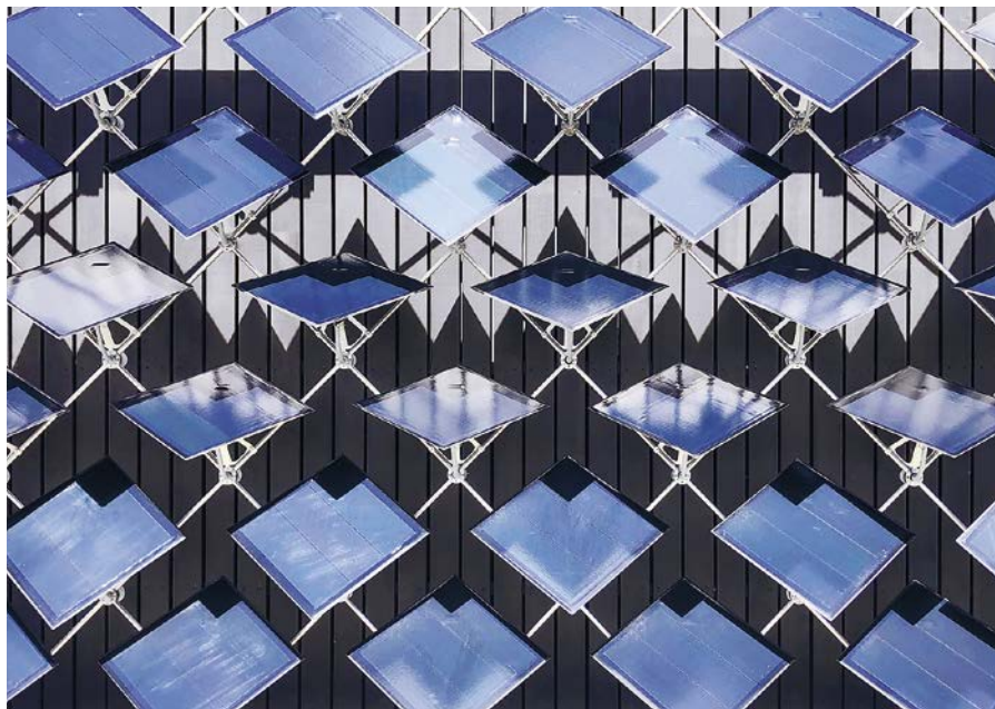
Bei der Solarfassade handelt es sich um einen Prototyp zu Forschungszwecken, deren Unterhalt sich von einer fertig entwickelten Fassade unterscheiden wird. (Foto: ETH Zürich / Arno Schlüter)
